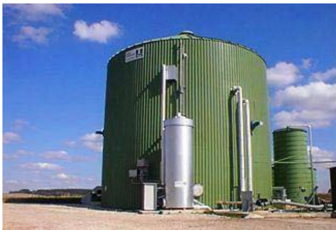
Метантенк — установка для переработки навоза в биогаз, Украина.
