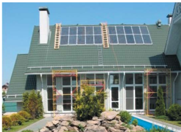
Солнечная электростанция: мощность солнечных батарей 3 кВт, инвертора — 13 кВА. Смонтирована в июне 2007 г. в Казани. Изготовитель ООО «ДЦА».
